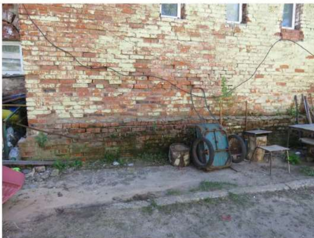
Фото 4. Состояние наружных кирпичных стен цоколя. Следы растительности на поверхности наружных стен здания.
