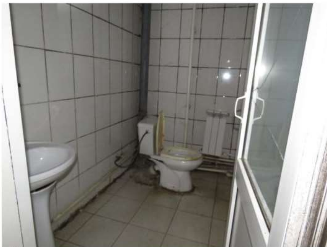
Фото16. Состояние приборов внутренних инженерных систем.
