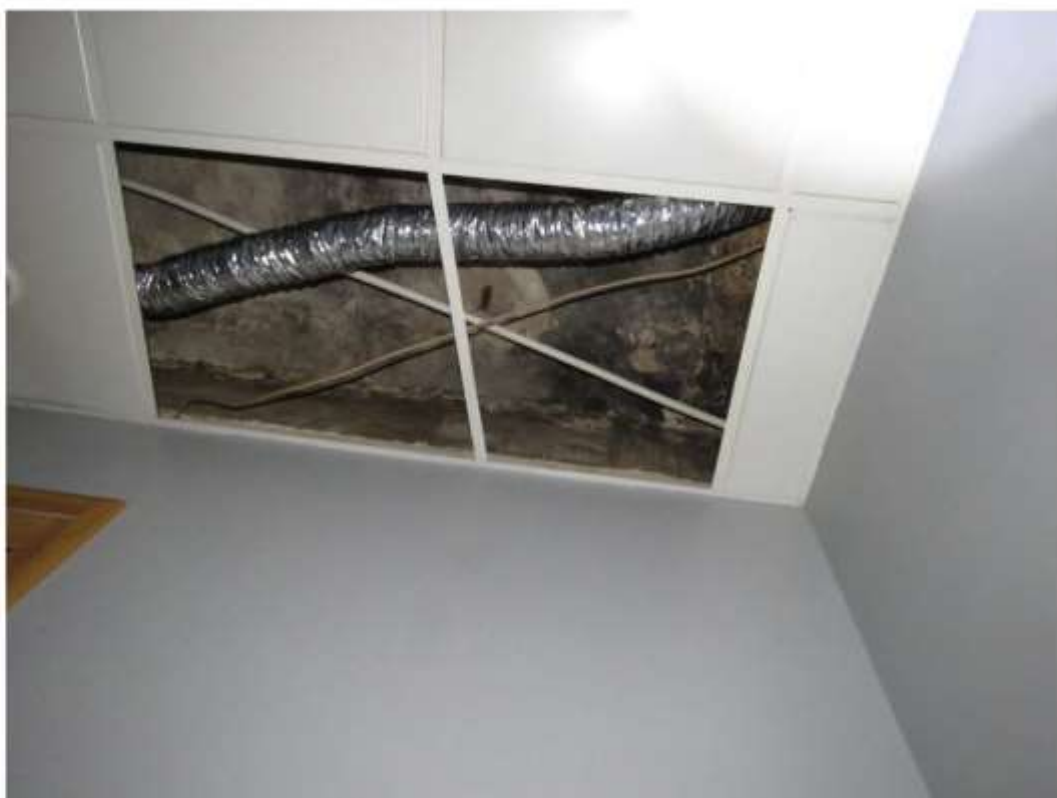
Фото 20. Следы протечек и грибка на поверхности перекрытия.
