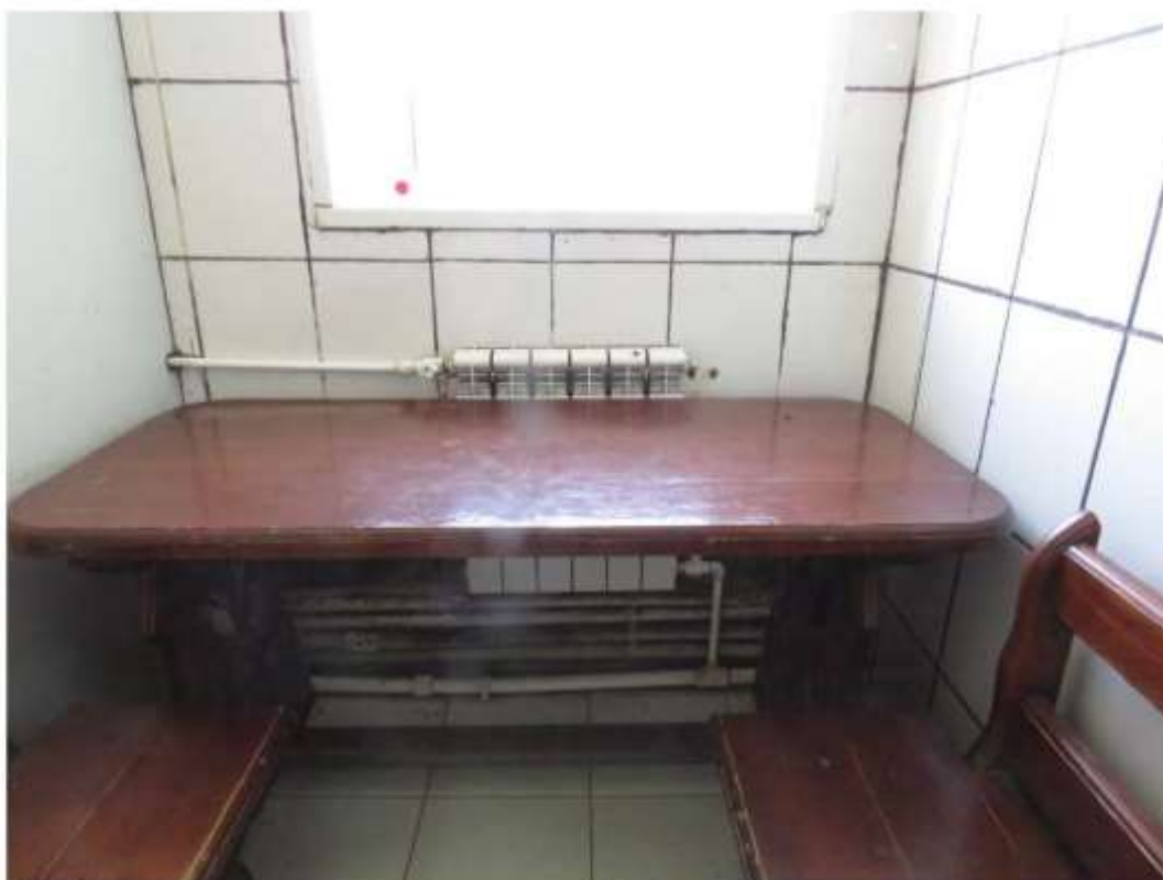
Фото 18. Состояние стояков и подводок к приборам отопления.
