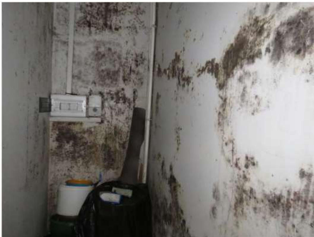
Фото 19. Следы грибка на поверхности стен в помещениях здания.
