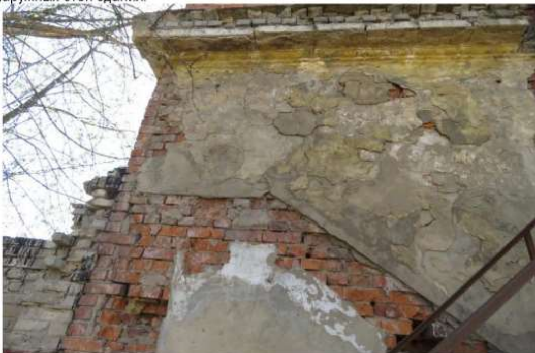
Фото 6. Общий вид и состояние наружной кирпичной стены.
