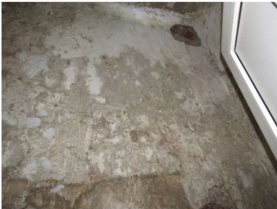
Фото 15. Следы повреждения и намокания на поверхности стен здания.
