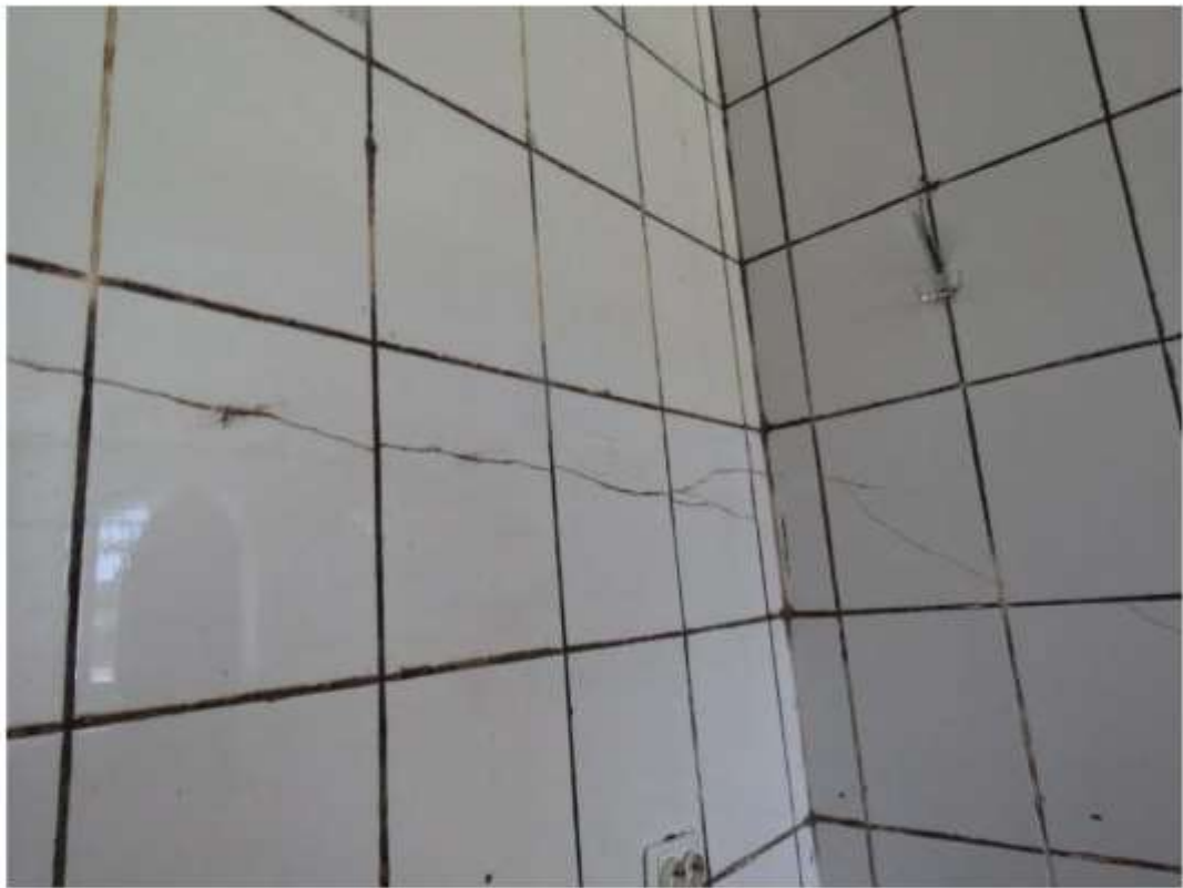
Фото 13. Разрушение отделочных слоев (керамической плитки) в помещениях здания.
