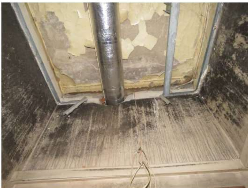
Фото 12. Следы грибка и отслоение отделочных слоев на поверхности стен и перекрытий.
