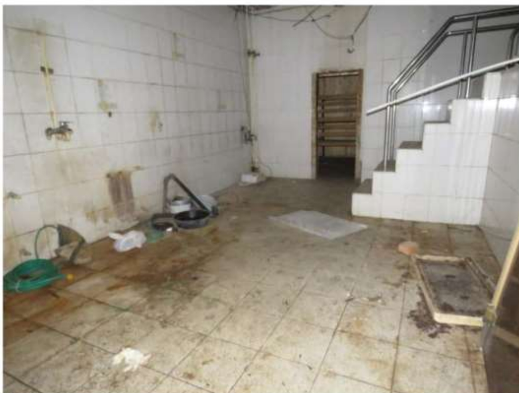
Фото 10. Состояние отделки помещений здания и инженерных систем.
