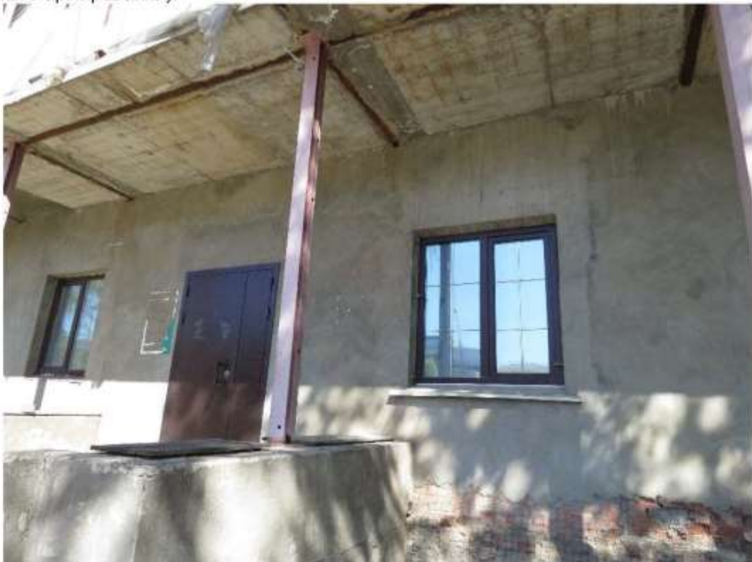
Фото 25. Состояние козырька входной группы.
