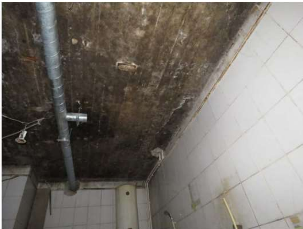
Фото 9. Следы высолов и грибка на нижней поверхности перекрытия.
