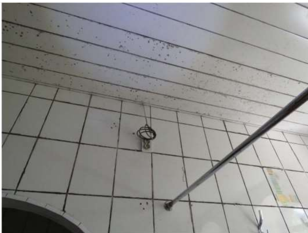
Фото 17. Следы грибка на поверхности потолка в помещениях здания.
