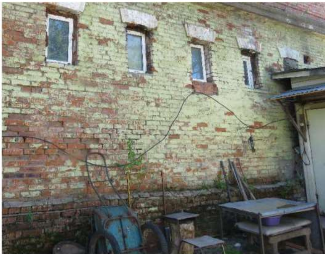
Фото 5. Состояние элементов оконного заполнения. Следы растительности на поверхности наружных стен здания.
